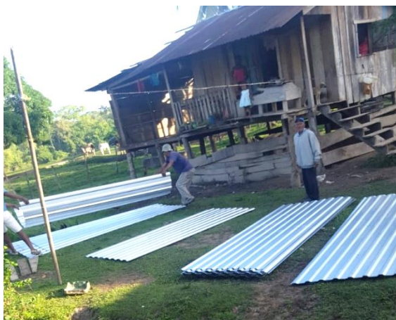
Verteilung der Wellbleche an geschädigte Bewohner in Pranzas .
